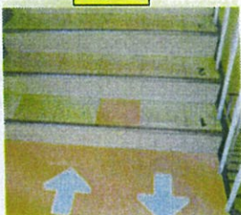
通行区分を定め、事故の多い下3段に段数を示し、注意喚起を図る。
